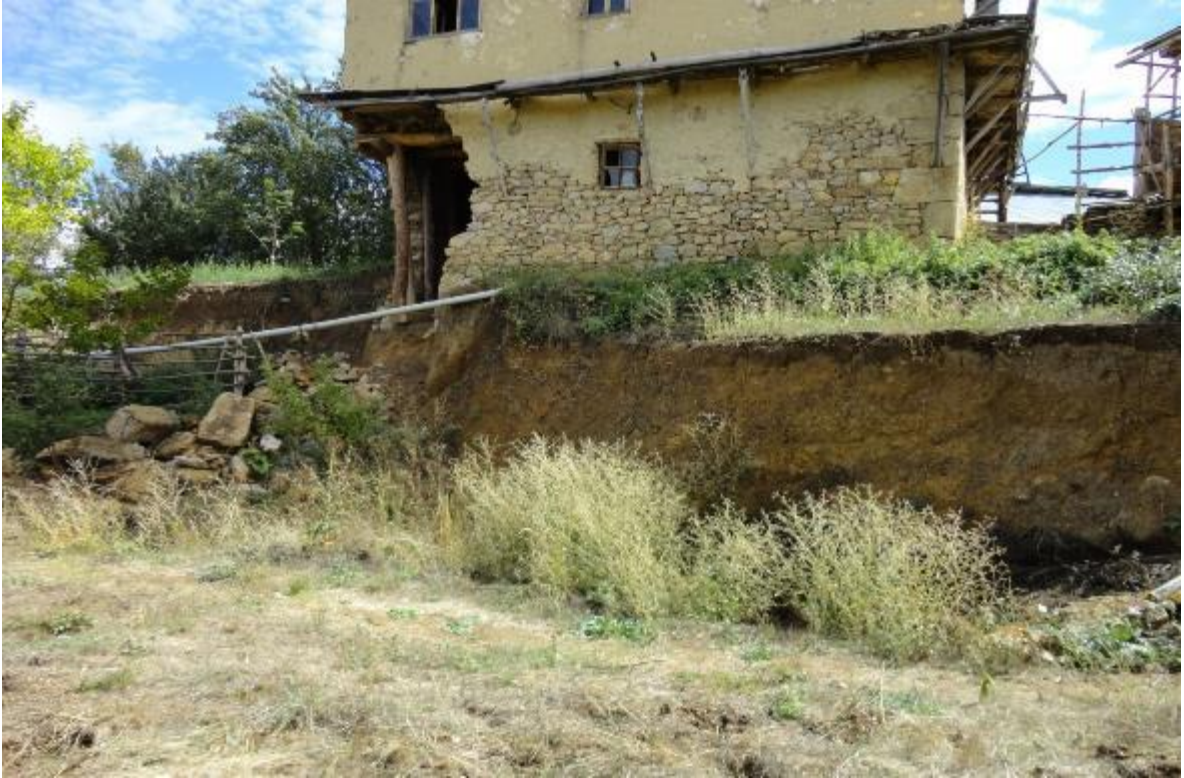
Resim 2.2: Gökseki Köyü'nde Meydana Gelen Heyelandan Görünüm (Erzincan AFAD)
