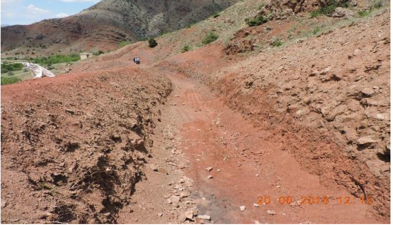
Resim 2.9: Kemah Taşbulak Köyündeki Kanal Açma Yöntemiyle Kaya Düşmesi Önleme Çalışmasından Bir Görünüm (Erzincan AFAD)
