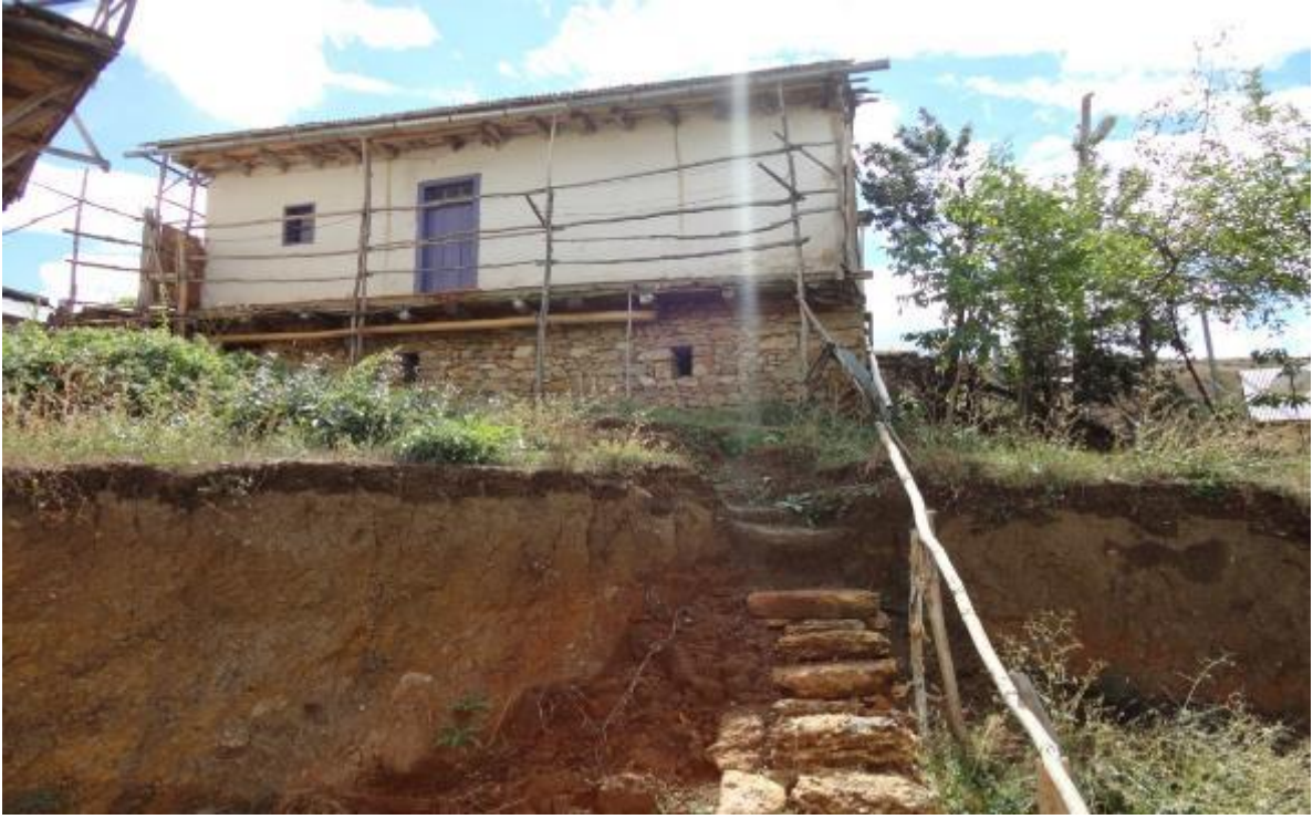
Resim 2.3: Gökseki Köyü'nde Meydana Gelen Heyelandan Görünüm (Erzincan AFAD)
