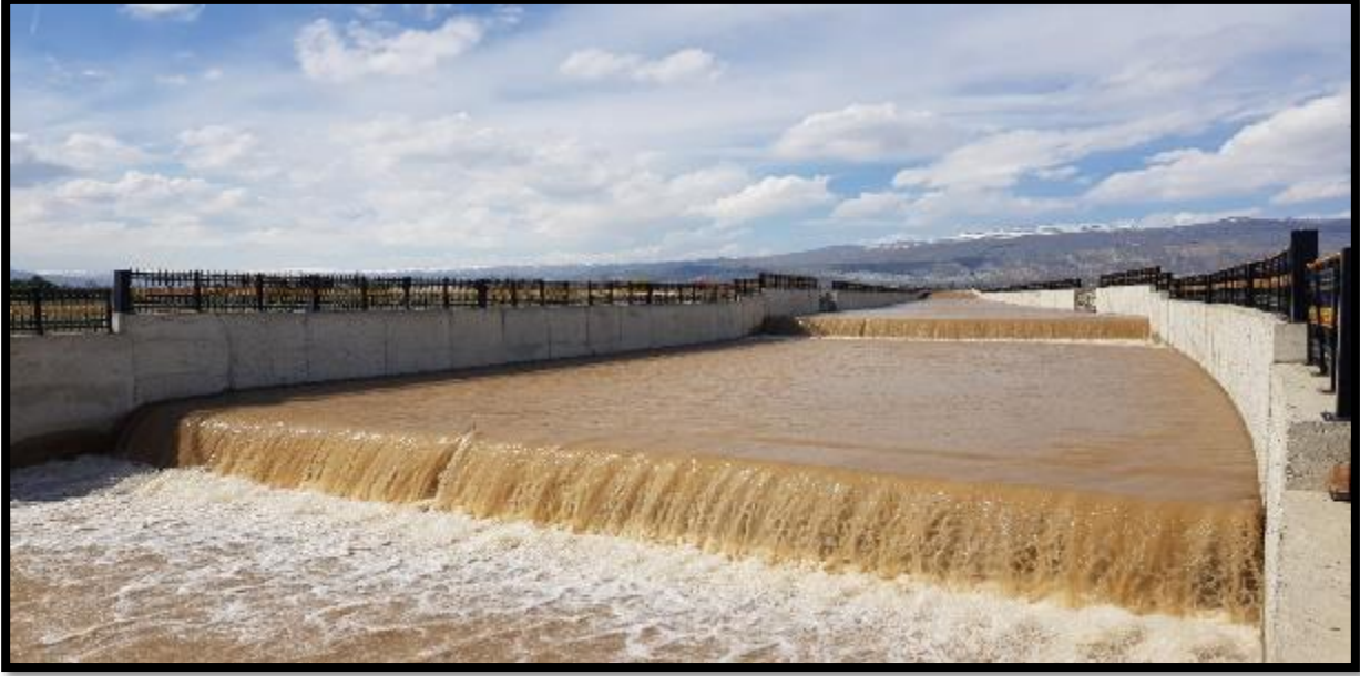
Resim 2.11: Taşkın Koruma Duvarı Örneği (D.S.İ. Genel Müdürlüğü)
